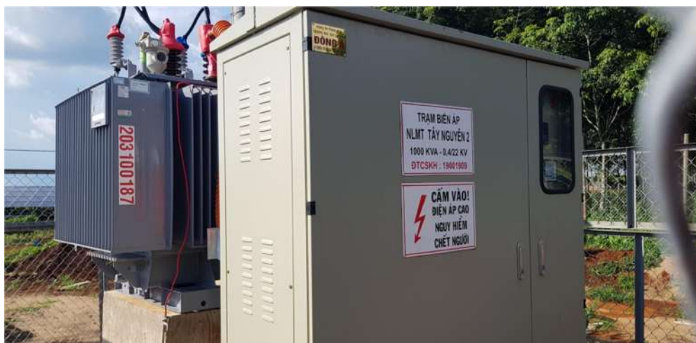
Trạm biến áp NLMT Tây Nguyên 2
